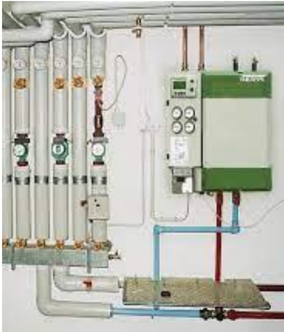
Wärmeübergabestation - Wandfläche ca. 2 m 2
