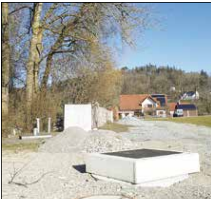
Der neue Pumpenschacht für die Schmutzwasserüberleitung Mundraching am Kalkbrennerweg. Links dahinter der alte Pumpenschacht und der alte Schaltschrank.
