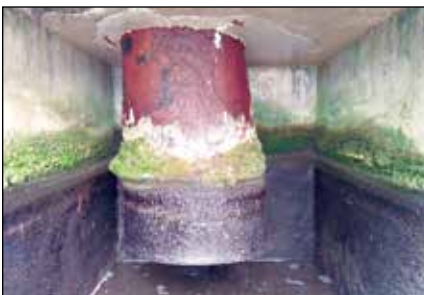
Das irreparabel verrostete Saugrohr im Turbinenschacht.
