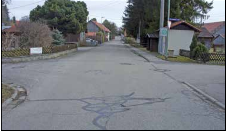
Sanierungsbedürftig: Die Rathausstraße in Pflugdorf.
