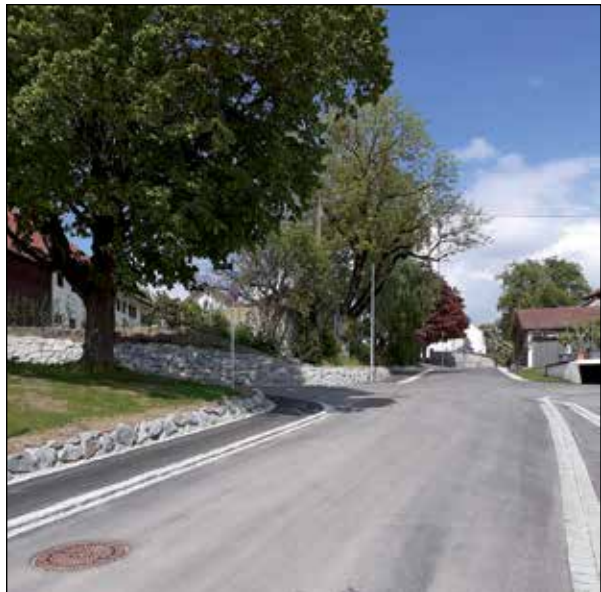
Abgeschlossen: Die Sanierung des Schmiedbergs in Stadl und der Bau der neuen Stützmauern.
