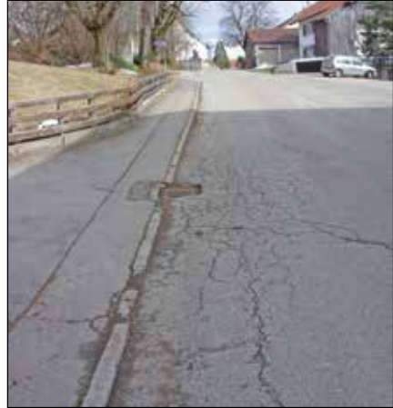
Sanierungsbedürftig: Der Schmiedberg in Stadl.
