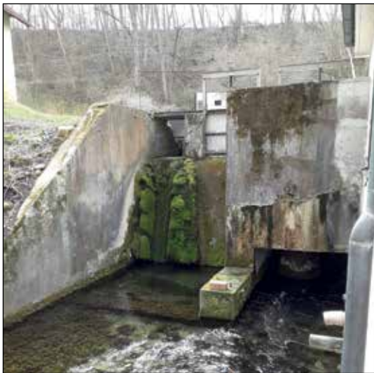
Sanierungsbedürftig: Die Betonmauern am Pumpenhaus der gemeindlichen Wasserversorgung in Lechmühlen. Bild: ath
