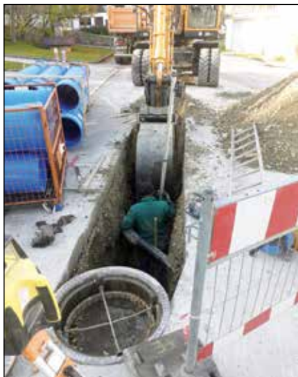
Sanierung des Regenwasserkanals in der Reichlinger Straße in Issing. Bild: Andreas Arnold
