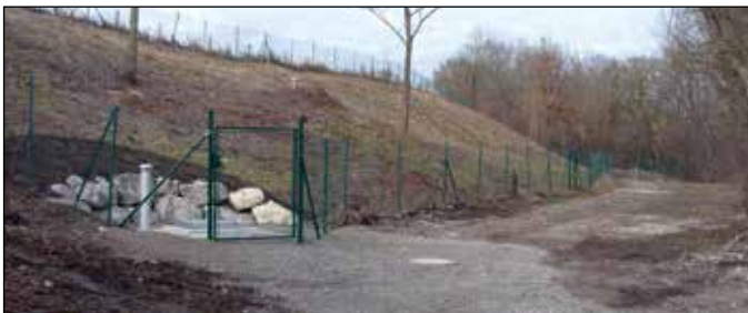
Fast beendet sind die Arbeiten am Trinkwassernetzverbund in Lechmühlen. Über der Fuchstaler Wasserleitung wurde ein Übergabeschacht gebaut (links), von dem eine Verbindungsleitung ungefähr am Zaun entlang zum Vilgertshofer Brunnen (rechts im Hintergrund) führt.
