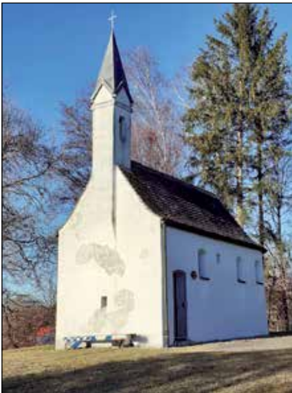
Die Abplatzungen an der Westfassade der Antoniuskapelle sind nur die sichtbarsten Schäden an dem kleinen Gotteshaus.
