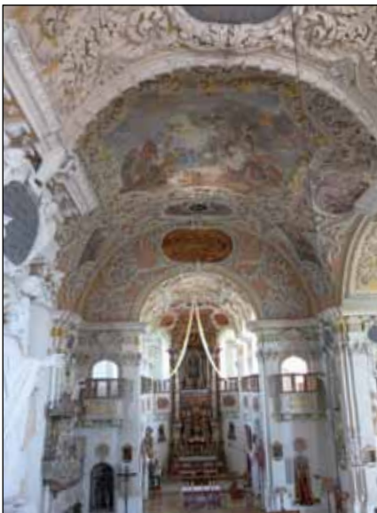
Im Innenraum wurden Risse geschlossen, der Stuck gesichert und der Staub und Schmutz von Jahrzehnten entfernt.
