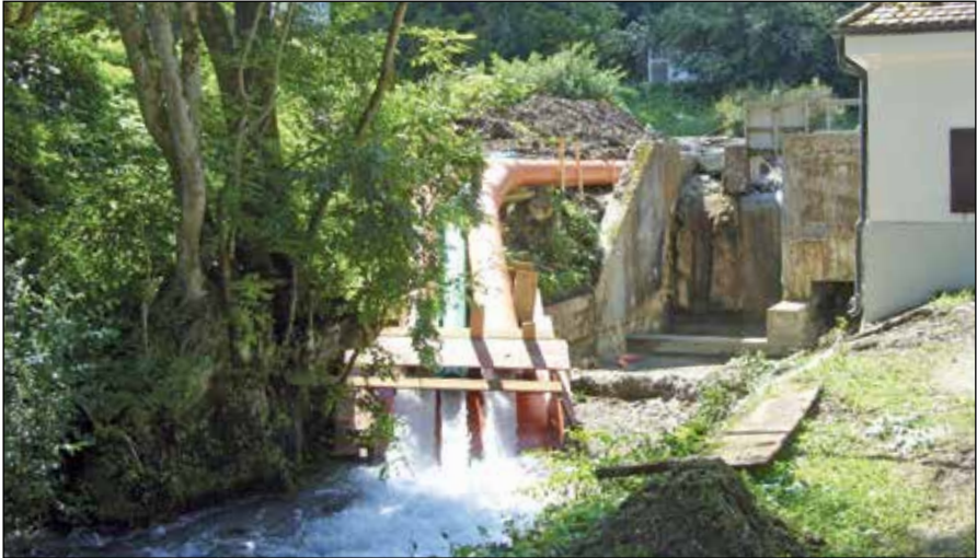
Der Mühlbach wird über drei Rohre umgeleitet und strömt unterhalb des trockengelegten Stauwehrs wieder tosend in sein Bachbett.
