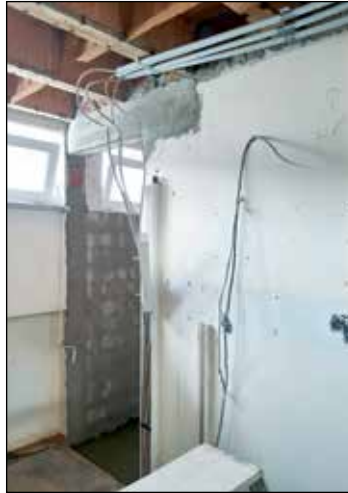
Wüst sah es Anfang September noch in den Toiletten vor der Turnhalle aus.
