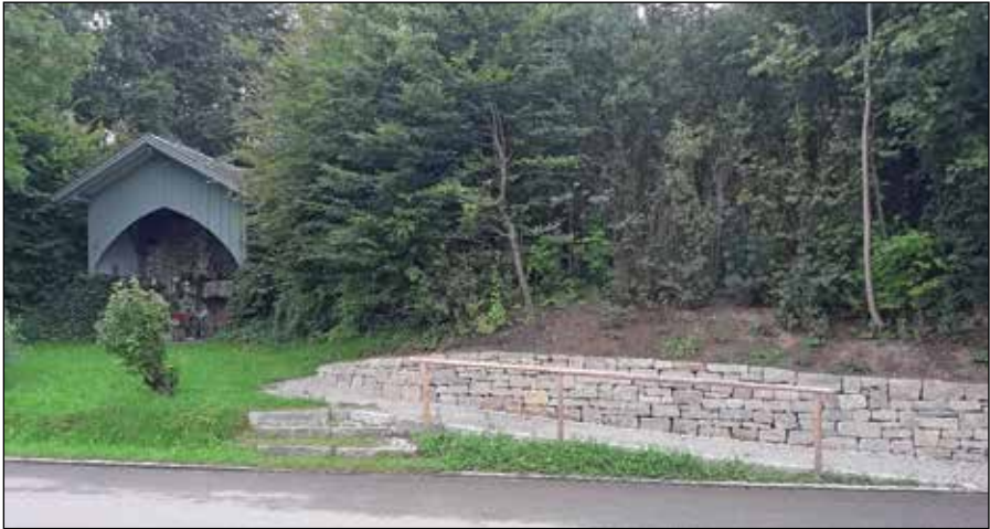
Der barrierefreie Zugang zur Grotte ist fertig, es fehlen aber noch Sitzgelegenheiten.
