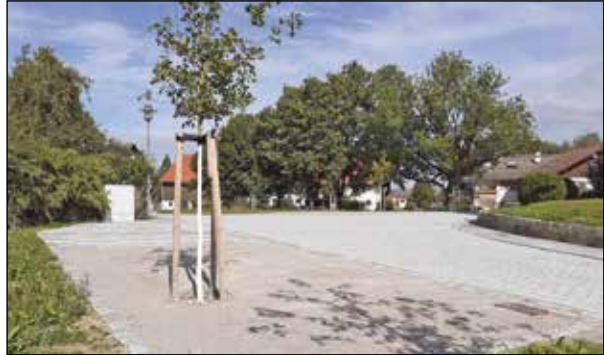
Pflaster ausgegangen: Die von der Baufirma vorgeschlagenen Gneisplatten reichten nicht für die ganze Fläche aus.
