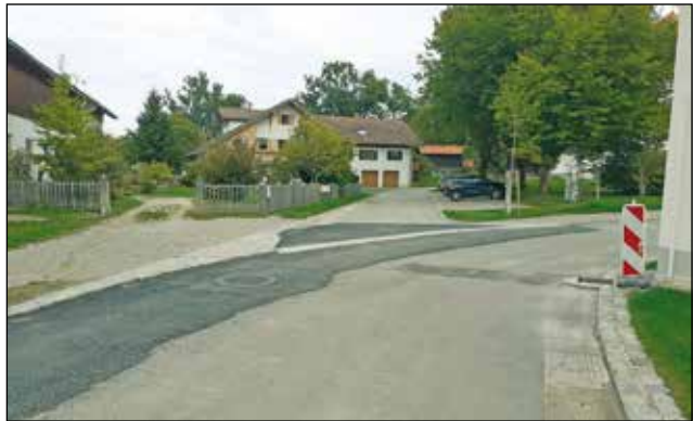
Nachgebessert: Die Kurve am Eingang des Vilgertshofer Ortsplatzes war von der Baufirma ohne Querneigung angelegt worden.
